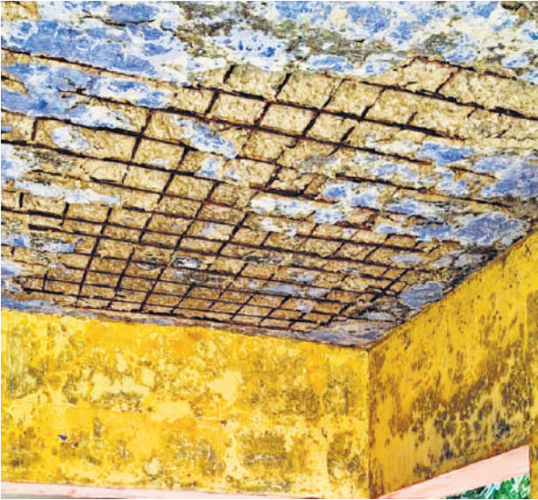
स्कूल भवन का बरामदा जिसकी छत के सरिए साफ नजर आ रहे हैं।
