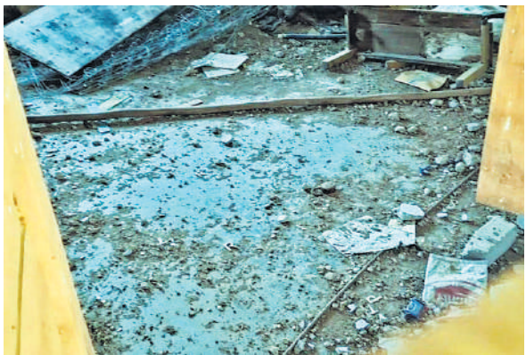
जर्जर स्कूल भवन के एक कमरे में गिरा हुआ है प्लास्टर और कंक्रीट, खिड़की से नजर आ रहा है साफ।
